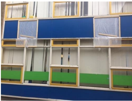
De buitenkant van het gebouw aan de Lengweg, waar noodreparaties zijn verricht omdat het hout verrot is
